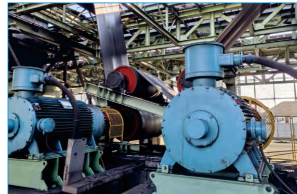
港口-皮带机、岸电电源、除尘风机、水泵等。
